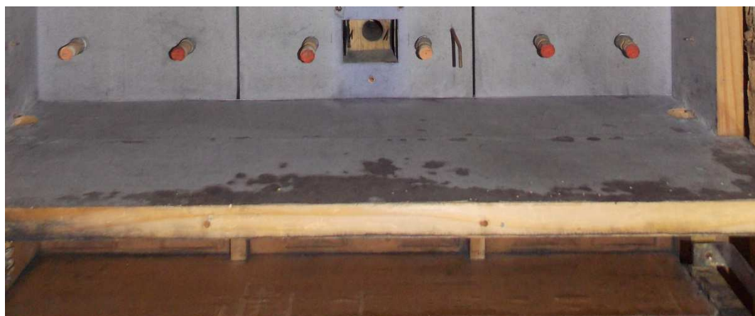
Obr. č. 33: V minulosti zatečený papierovaný rám vzdušnice Cs- strany.
