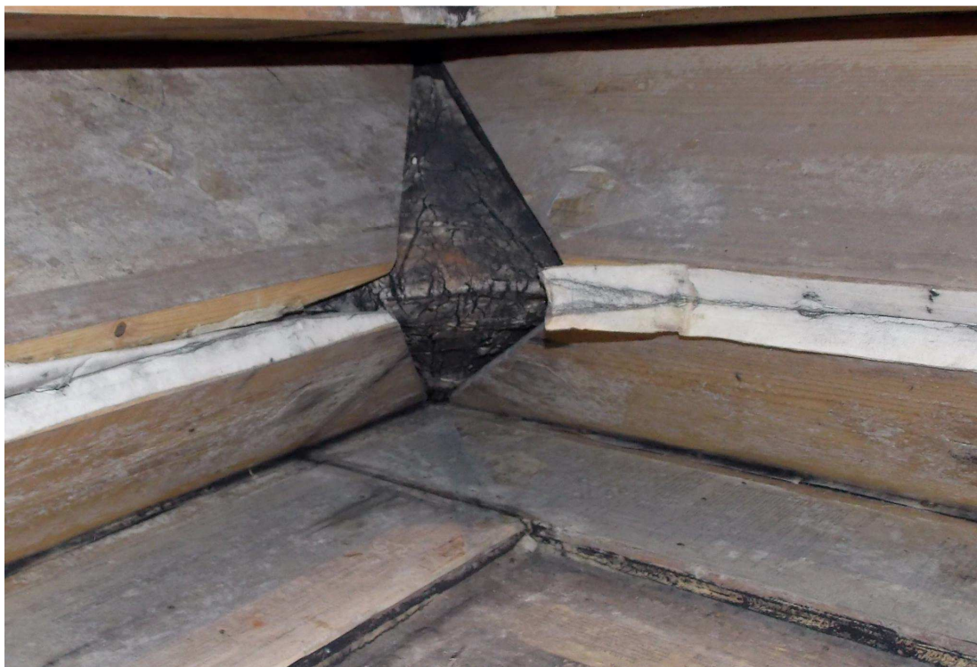
Obr. č. 39: Vnútorý roh zásobného mechu pred reštaurovaním.
