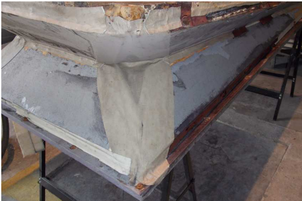
Obr. č. 26: Amatérsky sanovaný roh čerpaceho mechu – stav pri demontáži.
