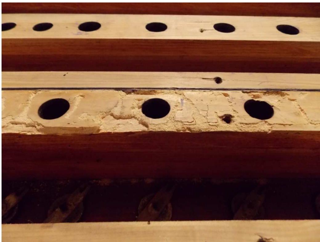
Obr. č. 42: Deštrukcia stien registrových kanciel drevokazným hmyzom.
