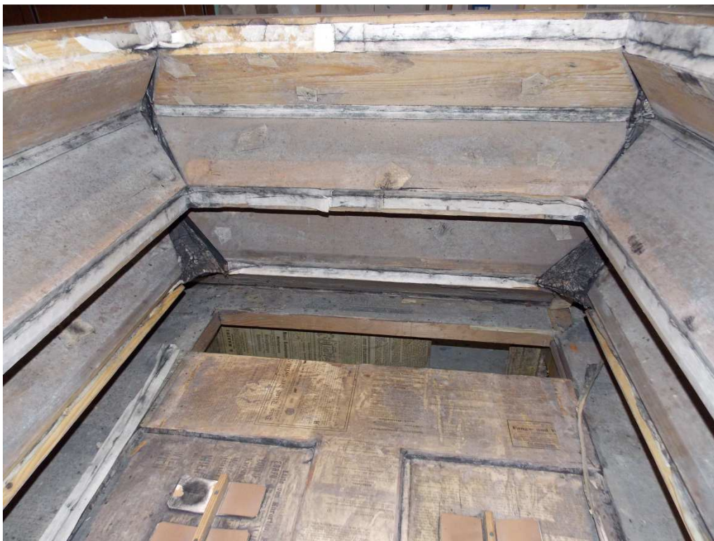
Obr. č. 37: Vnútorná časť zásobného mechu – stav pred reštaurovaním.
